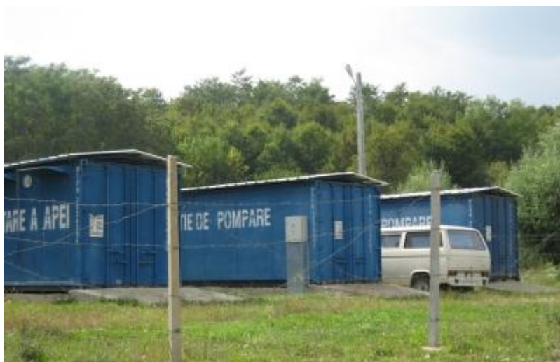
Noua stație de tratare și pomparea apă din Gura Calitei.
